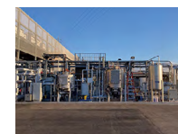
西尾ダイカスト工場 CO2分離・回収実証装置
