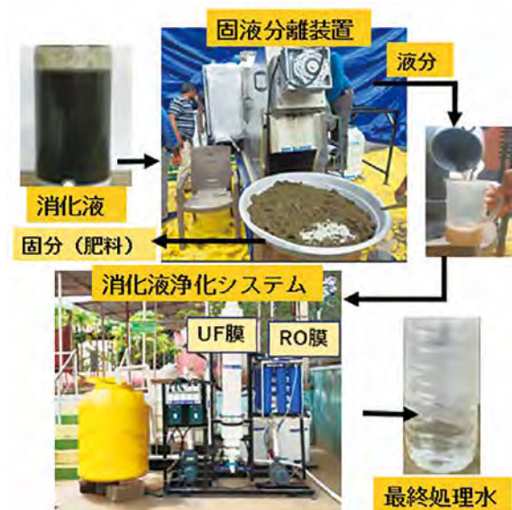
図14 消化液浄化システム写真
